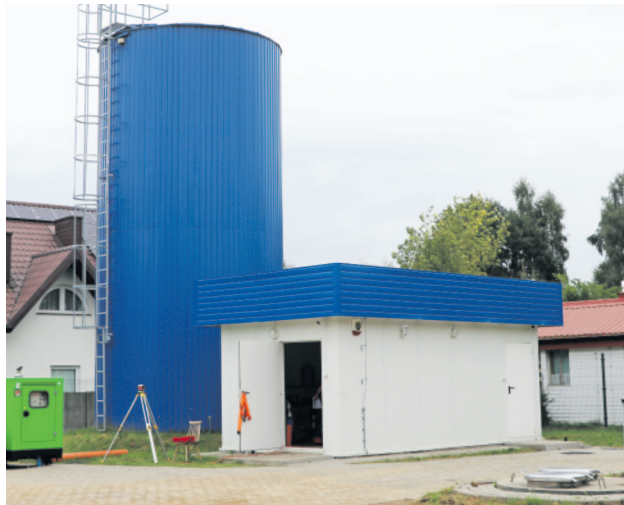
Istniejąca infrastruktura stacji wodociągowej w Janowie
