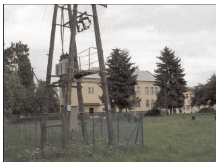
Na terenie ZSG w Giecznie ogrodzony został transformator średniego napięcia
