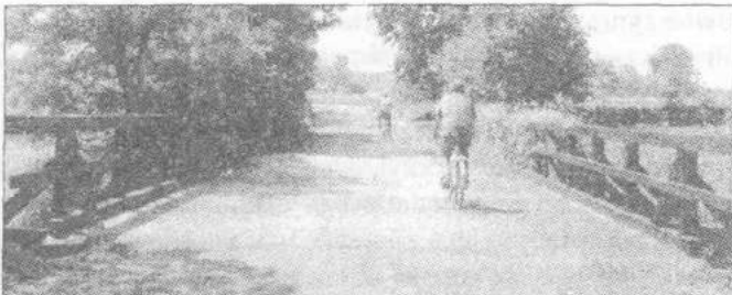
Most w Kotowicach, po wymianie pomostu górnej części jezdnej z poręczami na nowy przez pracowników gminnych robót publicznych. Prace te nadzorował Tomasz Kubik. Fot. Tomasz Soldenhoff
